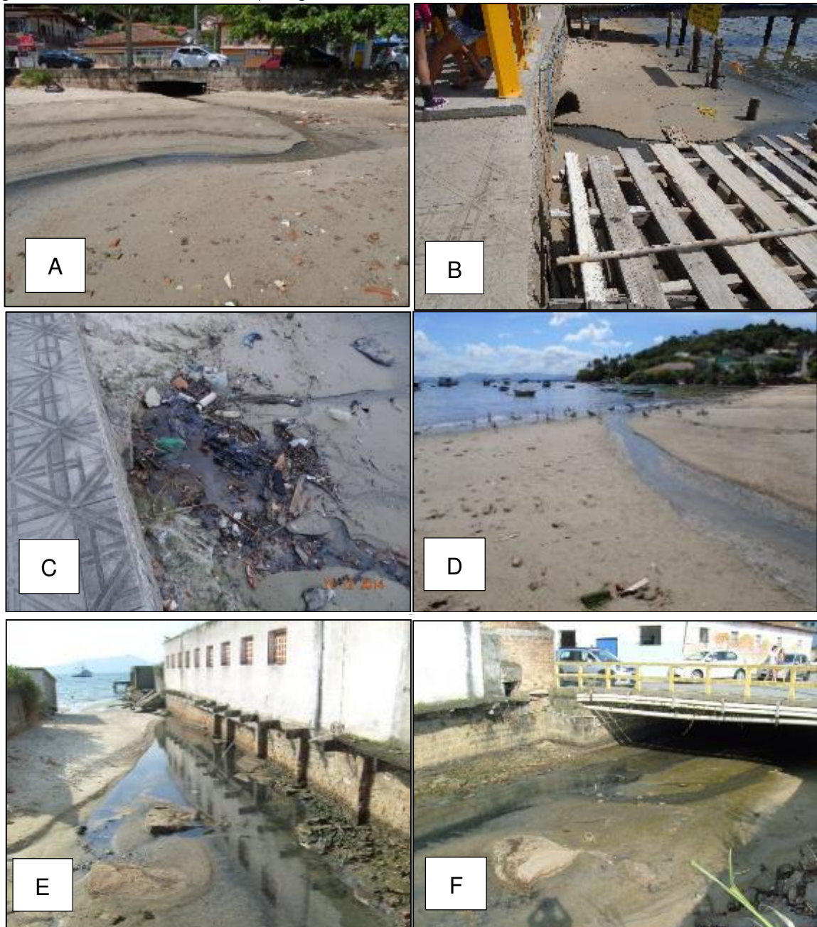
Figura 49 – A, B, C, D, E, F) esgoto a céu aberto no bairro Ganchos do Meio.
