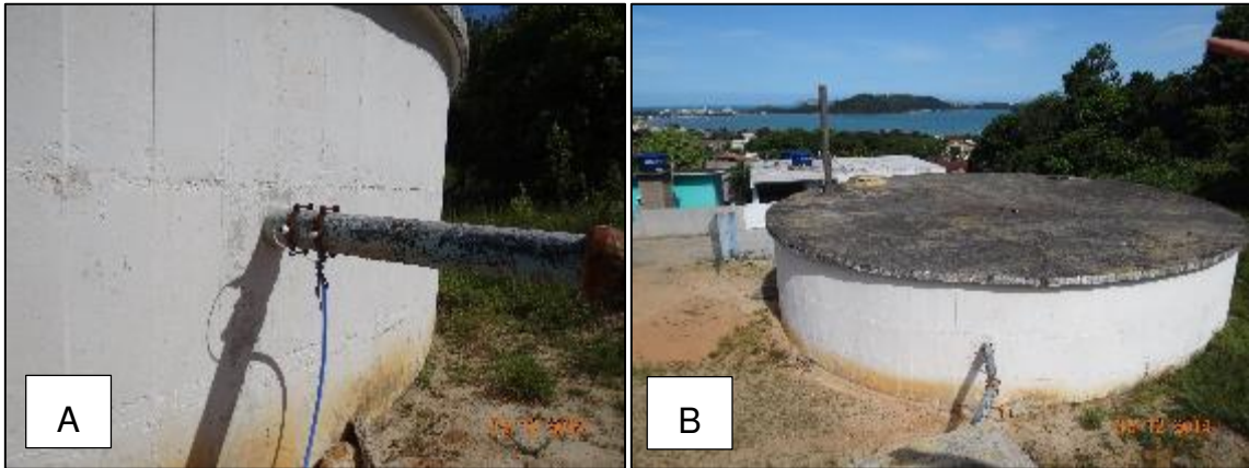
Figura 13 - A) Ponto de dosagem de cloro na entrada Reservatório 460 m 3 ; B) Reservatório 460 m 3 SAA ETA II Armação.
