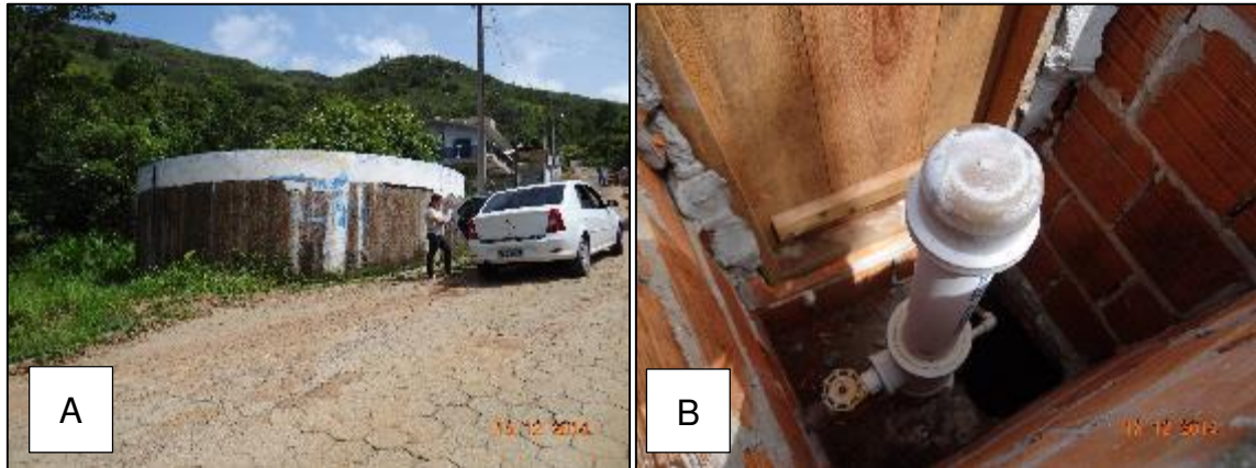
Figura 22 – A) Reservatório Canto dos Ganchos 100 m 3 ; B) Sistema de dosagem hypocal®.
