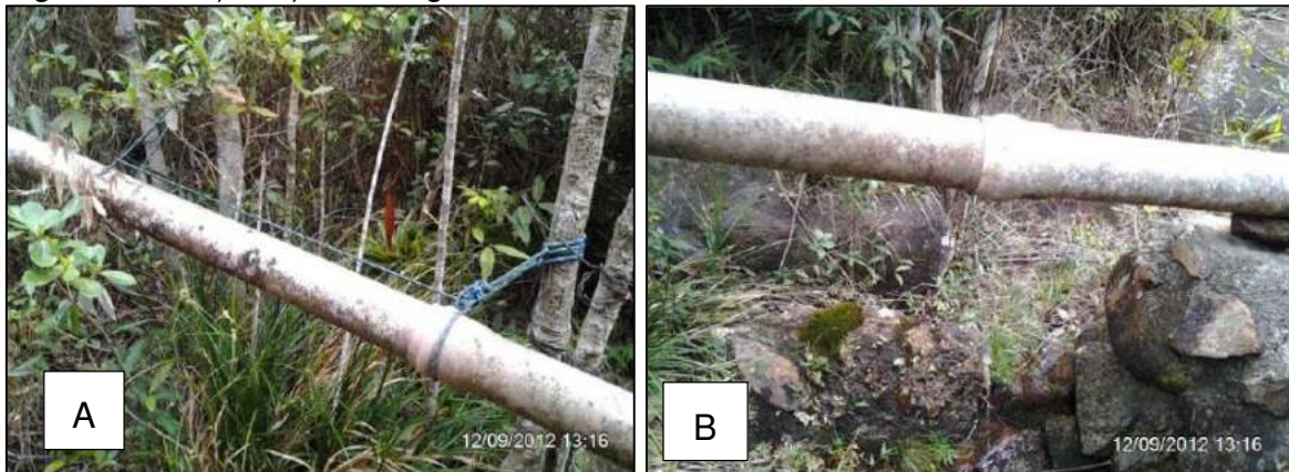
Figura 20 – A) e B) Ancoragem de adutoras de forma incorreta em Calheiros
