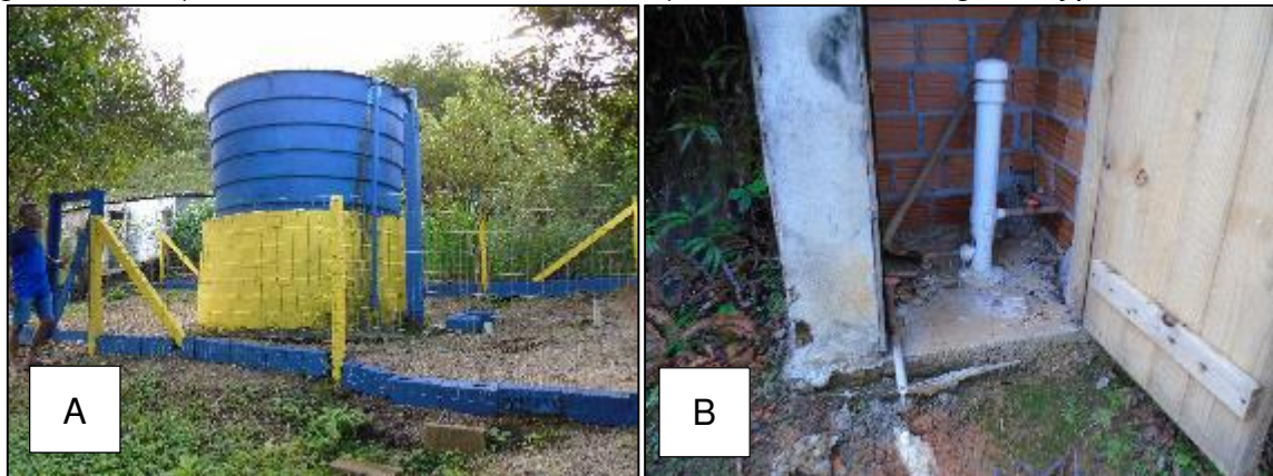
Figura 27 – A) Reservatório Caeira 20 m 3 ; B) Sistema de dosagem Hypocal.
