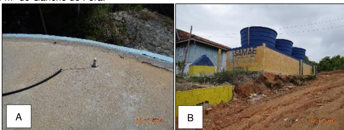
Figura 17 - A) Ponto de dosagem de cloro no Reservatório; B) Três reservatórios de 20 m 3 de Gancho de Fora.
