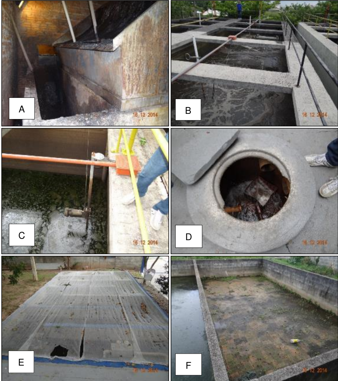
Figura 53 – A) peneira estática; B) Tanque de aeração por batelada; C) Misturador Submersível; D) Detalhe de pastilhas de cloro a montante do tanque de Contato de cloração; E) Tanque de Cloração; F) Leitões de Secagem.
