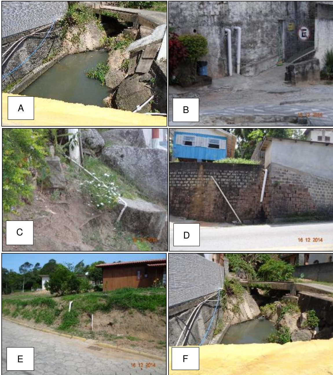
Figura 50 – A e F) Canal com esgoto a céu aberto em Ganchos de Fora; B, C, D e E) Esgoto a céu aberto em outras localidades.
