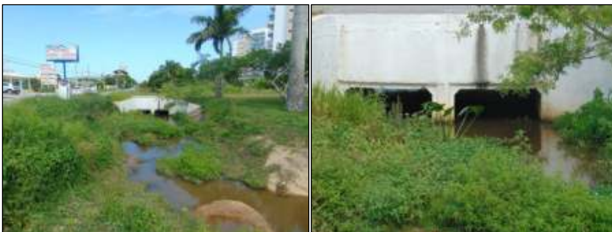
Figura 25 – Canal de drenagem.
